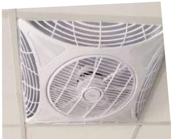
Un brasseur d'air installé à l'école Renaudel.
