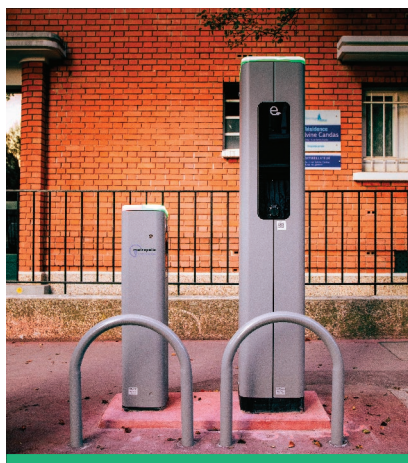
De nouvelles bornes Métropolis permettent aux Montrougiens de recharger leur véhicule électrique et ainsi d'accélérer la transition électrique.
