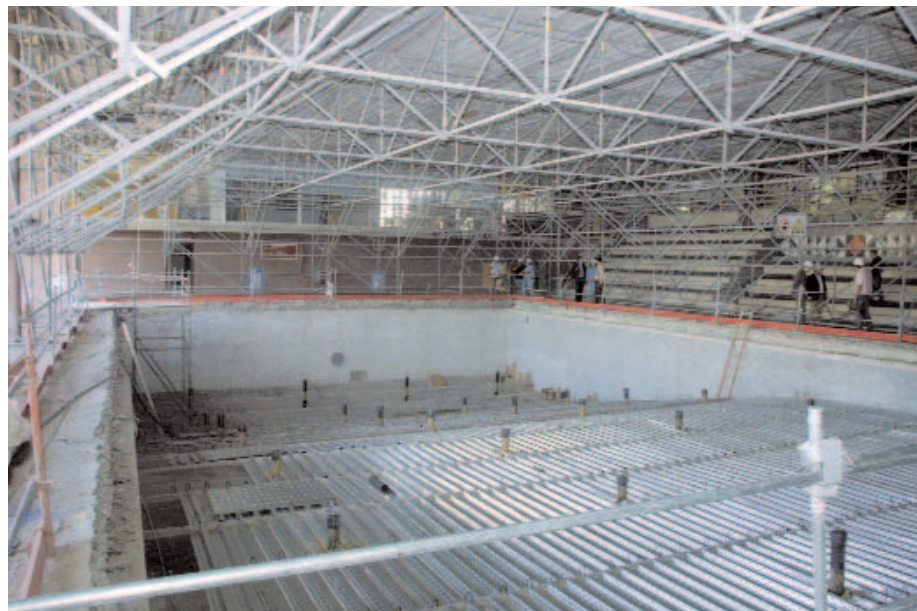
Le chantier de la piscine est au cœur de l'actualité du premier semestre 2006
